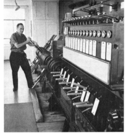
SBB-Stellwerk Bahnhof Rotkreuz
